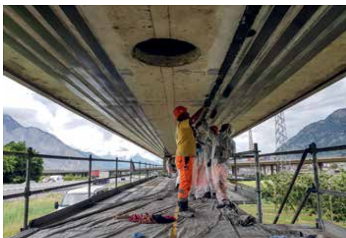
Pose des polymères renforcés de fibres de carbone (PRFC) sous le caisson des bretelles (INGPHI)
