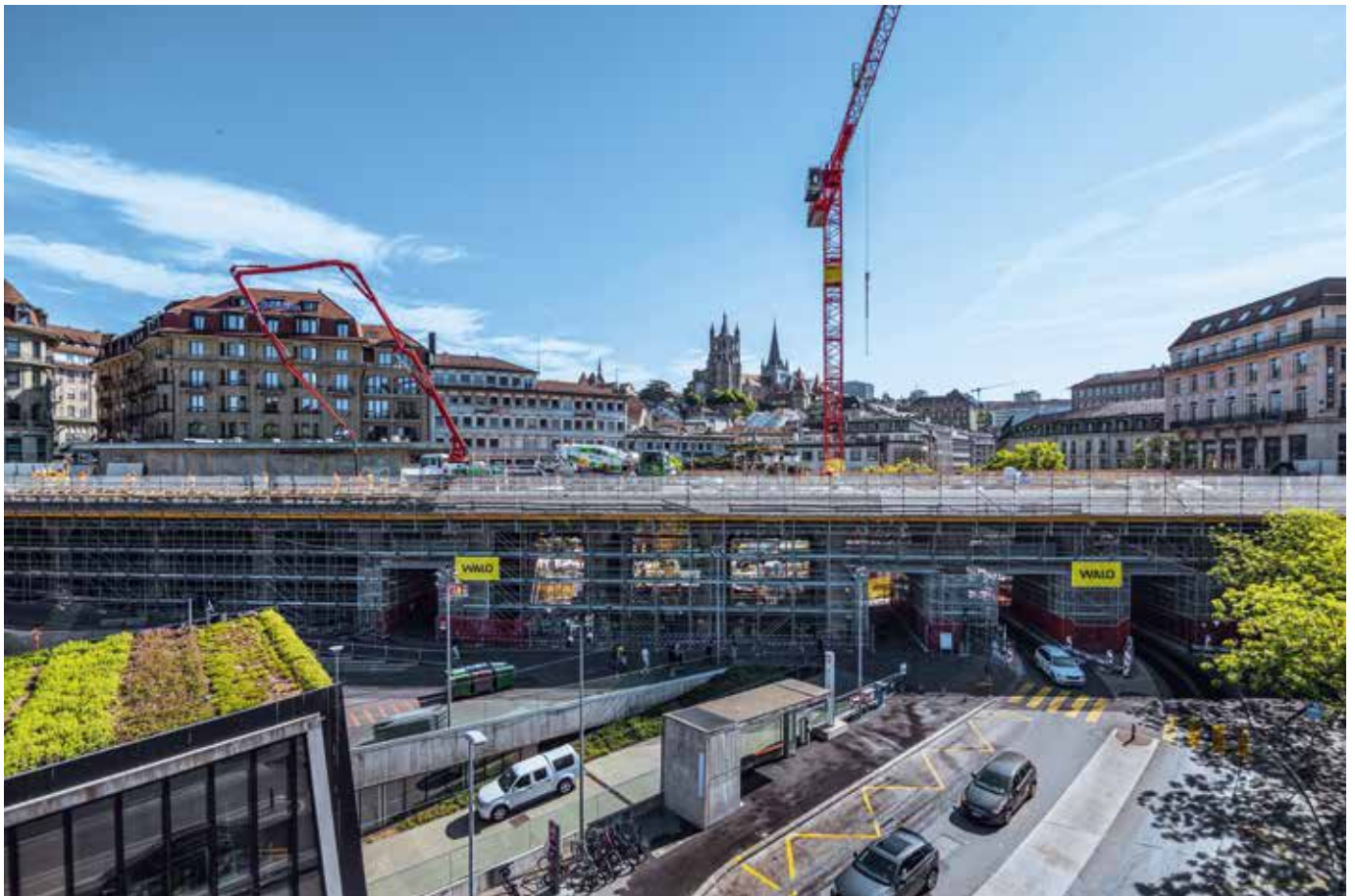
Vue des échafaudages et cintre pour les travaux de remise en état (PHOTODRONE.PRO)
